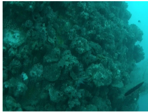
圖 2.1.8-2 D07 基樁表面生長藤壺照
